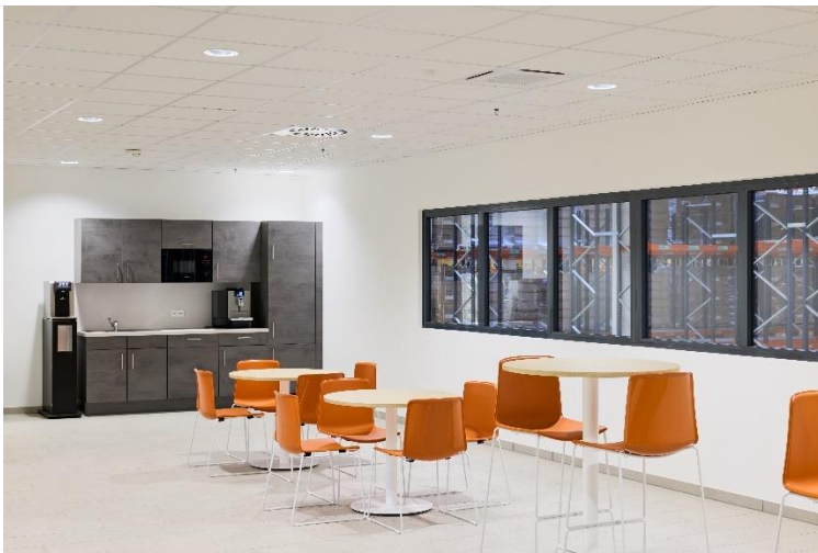
PK1272-461: Die Büro- und Aufenthaltsbereiche werden mit Klimaaußengeräten der PUMY-Baureihe und 53 4-Wege-Deckenkassetten in unterschiedlichen Leistungsgrößen aus der City Multi-Serie klimatisiert.
