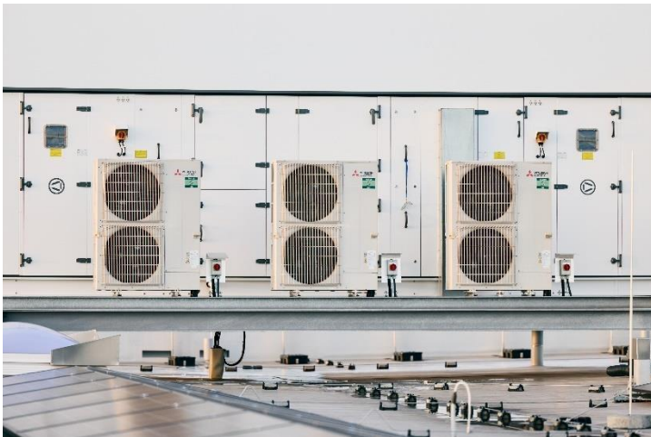
PK1272-301: Die energieeffizienten und umweltschonenden Heiz- und Klimälösungen von Mitsubishi Electric LES wurden im neuen Logistikzentrum verbaut.
