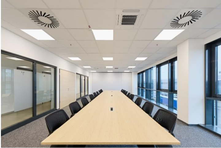
PK1272-455: Die Büro- und Aufenthaltsbereiche werden mit Klimaaußengeräten der PUMY-Baureihe und 53 4-Wege-Deckenkassetten in unterschiedlichen Leistungsgrößen aus der City Multi-Serie klimatisiert.
